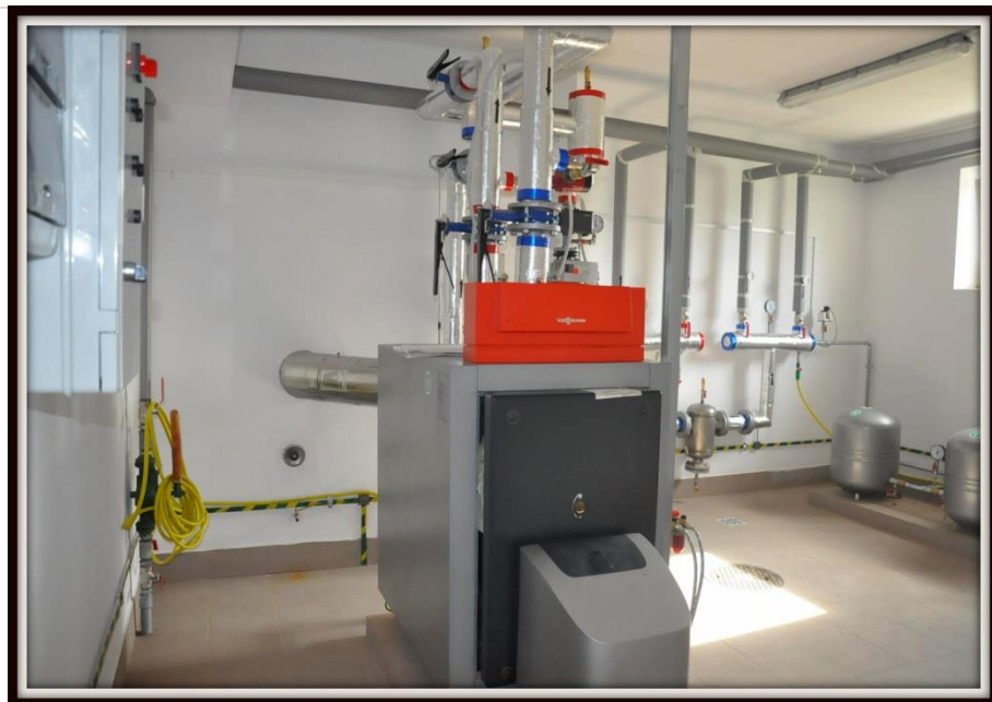
KOTŁOWNIA W SZKOLE PODSTAWOWEJ ŁUSZCZACZU
